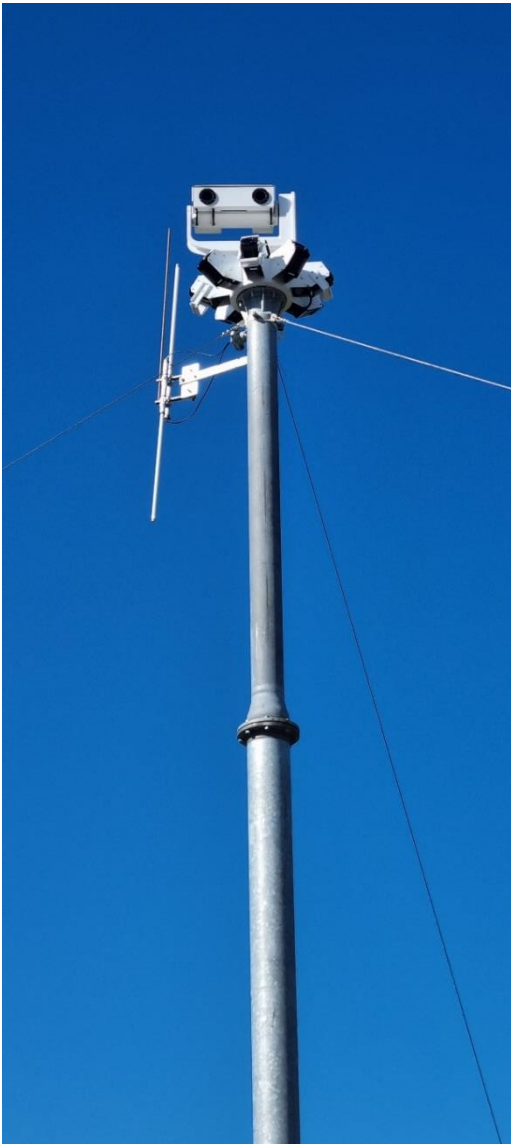
Abbildung 12: Abgespannter IDF Turm
