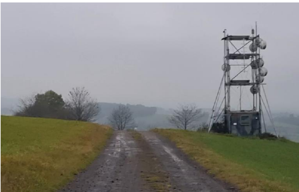
Abbildung 6: Sendeinrichtung am Weg westlich vom Standort des IDF 2
