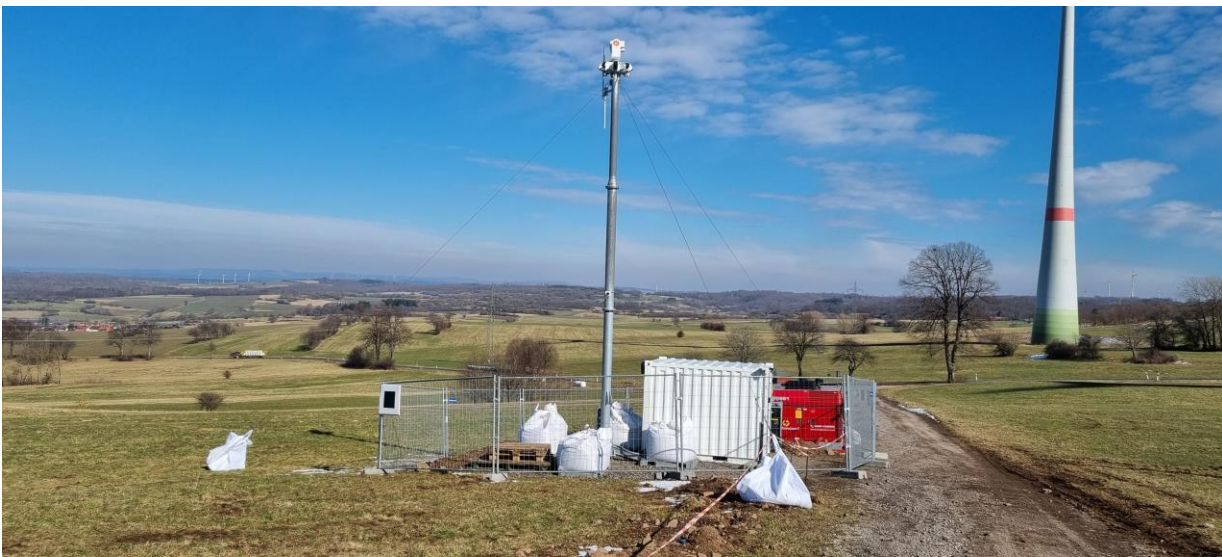
Abbildung 13: Installiertes System IDF 1 im März 2022
