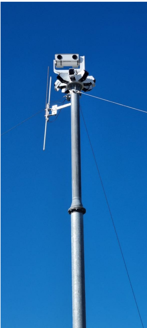
Abbildung 12: Abgespannter IDF Turm
