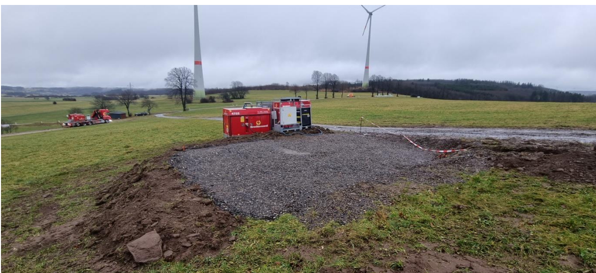
Abbildung 9: Anlieferung und Aufbau der Stromversorgung am Standort IDF-1, im Vordergrund die temporär geschotterte Standfläche (154 m 2 )
